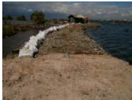
Overtopped Polder Dike
